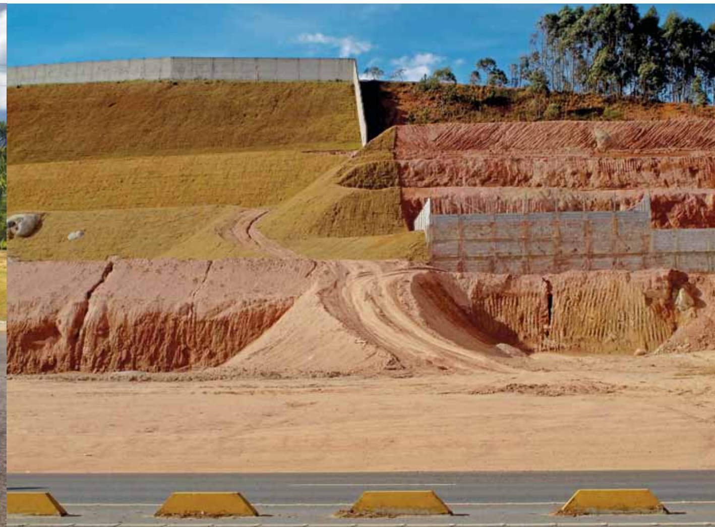
Área na margem de estrada em Bragança Paulista, retificada para a implantação de empreendimento comercial
